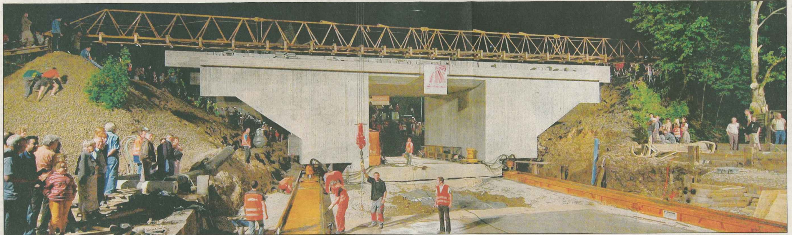
NÄCHTLICHES SPEKTAKEL: In der Zeit von 21.20 bis 21.50 am Sonntag schwebte die Brücke zentimetergenau in ihre vorgesehene Position im wiederaufzuschüttenden Bahndamm. Während das Verschieben der neuen Brücke problemlos klappte, sorgte der Abriss der alten Brücke zuvor für Zeitverzögerungen. Das vorgefundene Betonfundament war ungewöhnlich hart. Foto: Martin Schott
