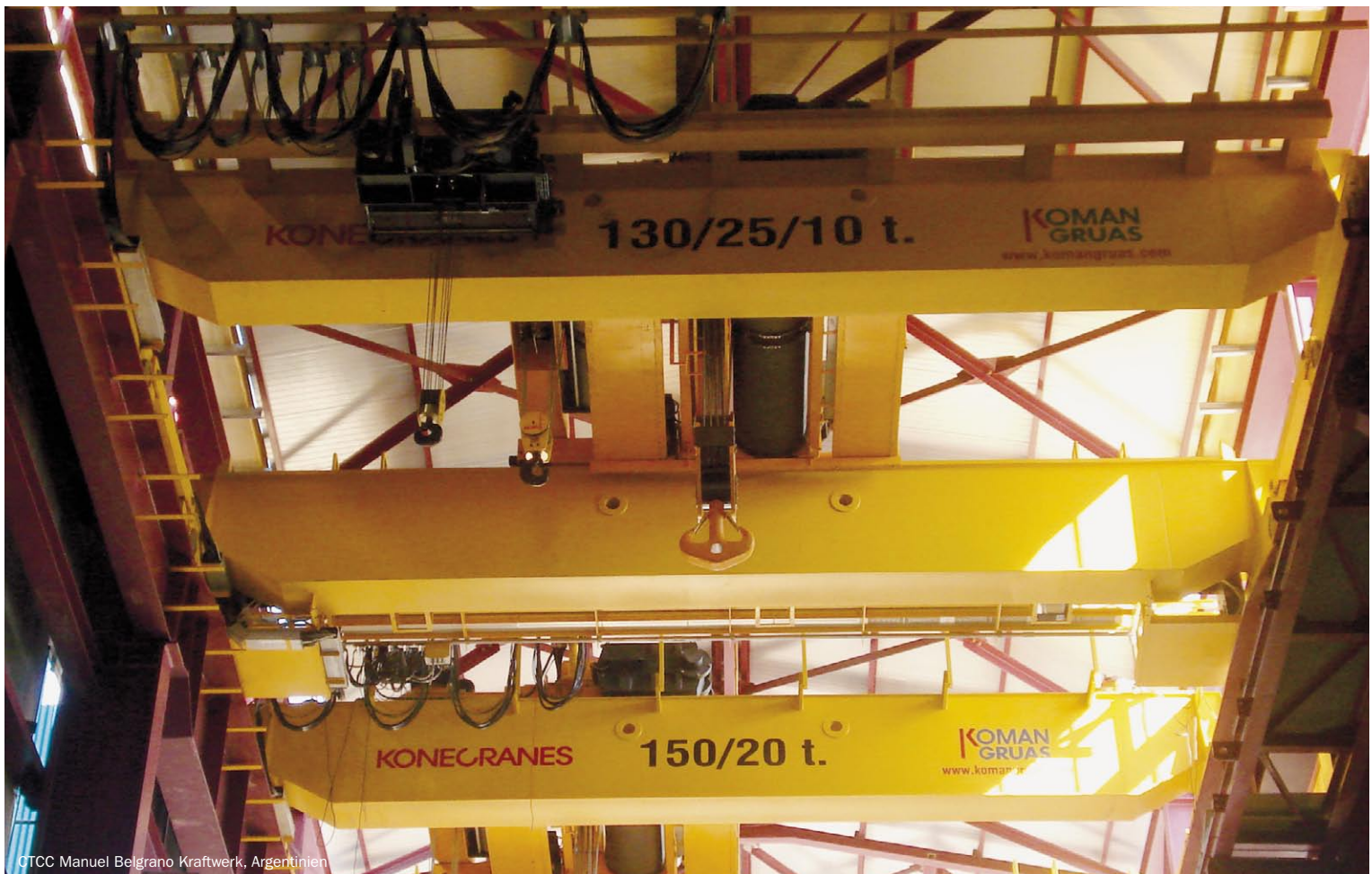
OTCC Manuel Belgrano Kraftwerk, Argentinien
