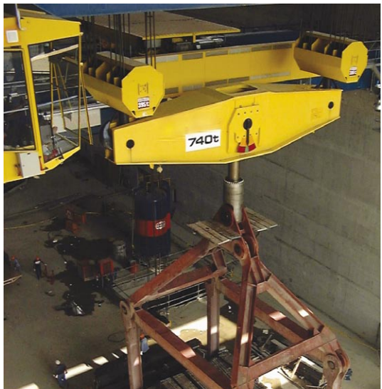
Caruachi Kraftwerk, Venezuela
